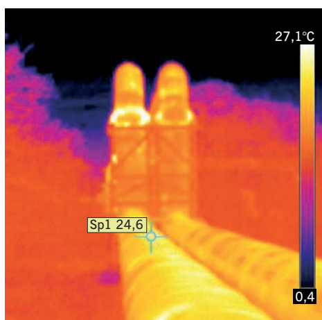
FOT. Obraz termowizyjny rur przesyłowych;
